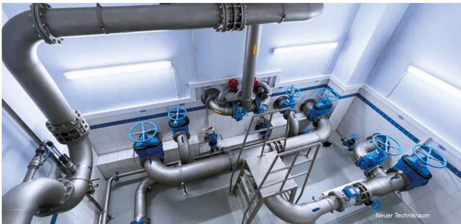
Wasserkammern mit Edelstahlauskleidung
